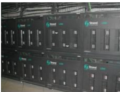
Módulos de dimmer de pared existentes.
